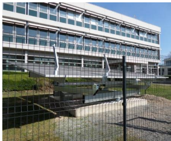
Figure 30 : Tracker solaire (Strasbourg)
